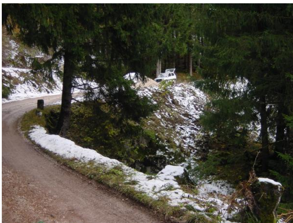
Figura 62. Tratto a valle della strada di Cavelonte ove è previsto la rettifica della strada per allontanarsi della zona di frana.
