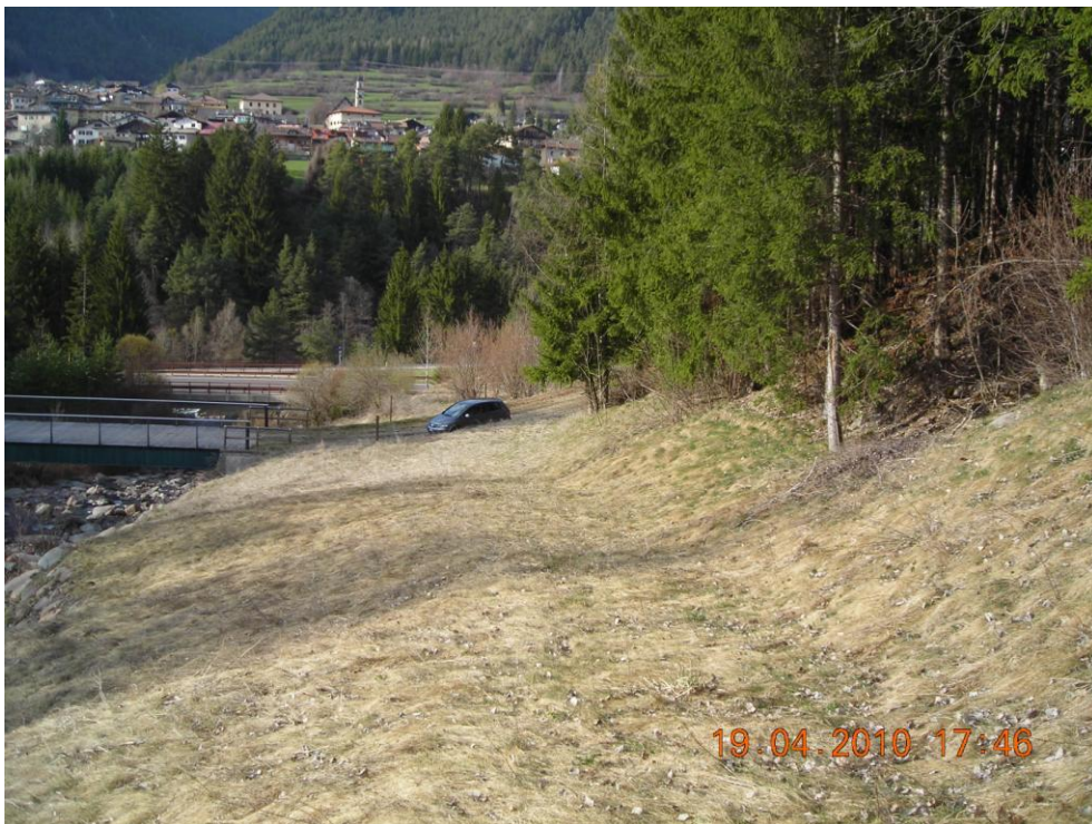
Figura 13. Posa condotta e cavidotti (linee elettriche) a lato rio Cavelonte. La posa deve avvenire ai piedi del cambio pendenza (vedasi planimetria).
