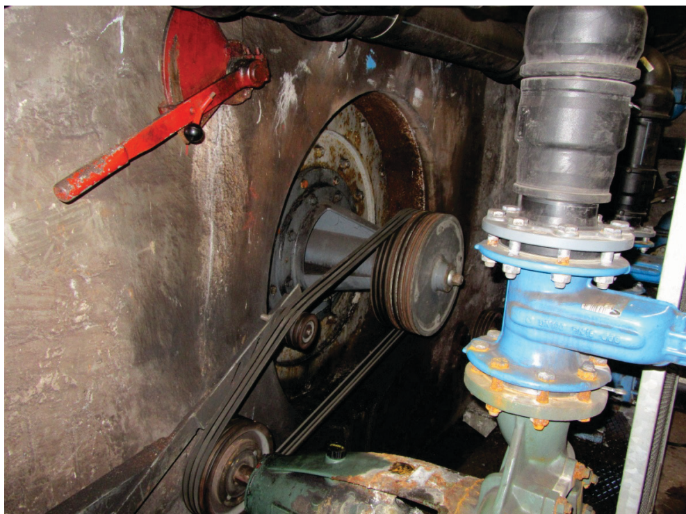
Figura 12 – Asse turbina e pompa centrifuga di sollevamento
