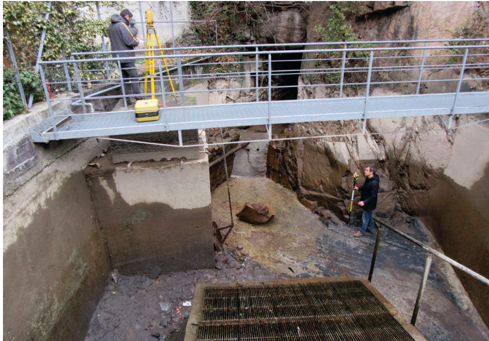
Figura 11 – Interno vasca di carico
