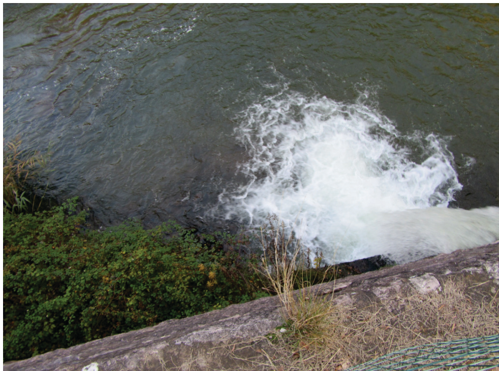
Figura 13 – Scarico in alveo
