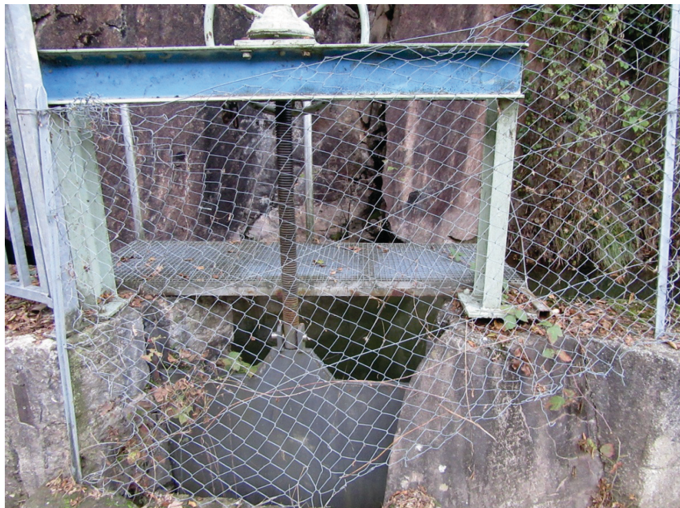
Figura 6 – Paratoia intermedia sul canale derivatore
