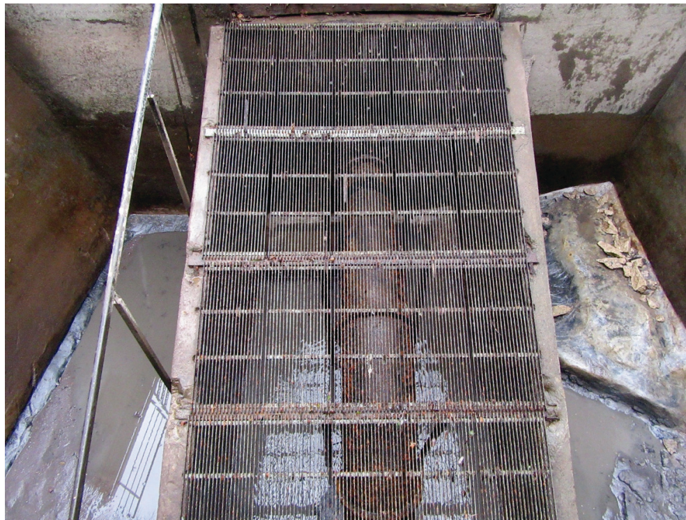
Figura 9 – Griglia di captazione in vasca di carico
