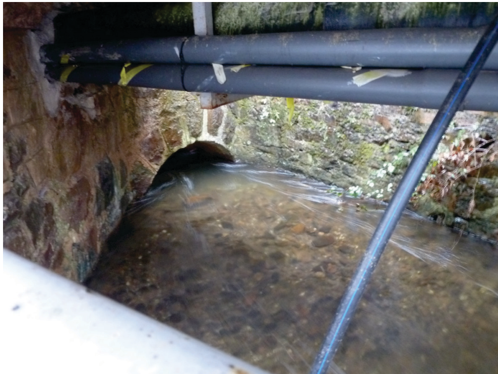
Figura 3 – Volume opera di presa dietro la griglia in alveo e sotto la strada; in evidenza il deposito di materiale sciolto e l'imbocco del canale
