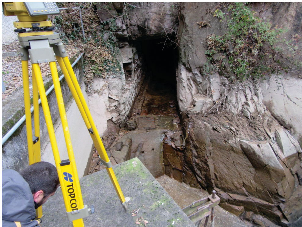
Figura 8 – Sbocco canale derivatore in vasca di carico
