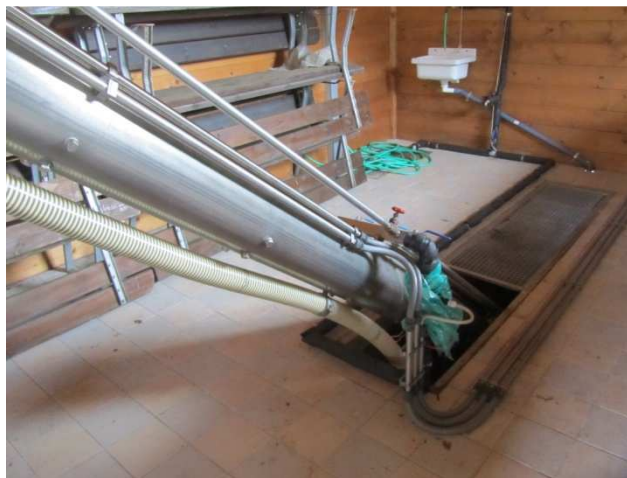
Figura 7. Locale grigliatura di Carbonare, con filtrococlea.
