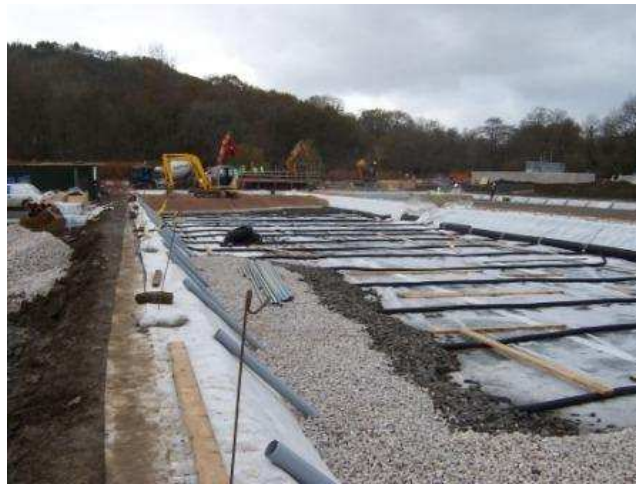
Figura 38. Immagine della realizzazione di un sistema VSSF con particolare dei tubi di drenaggio impiegati anche per l'aerazione.
